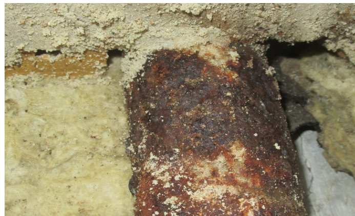
Eksempel på kraftig rusttæring i bærende stålsøjler.
