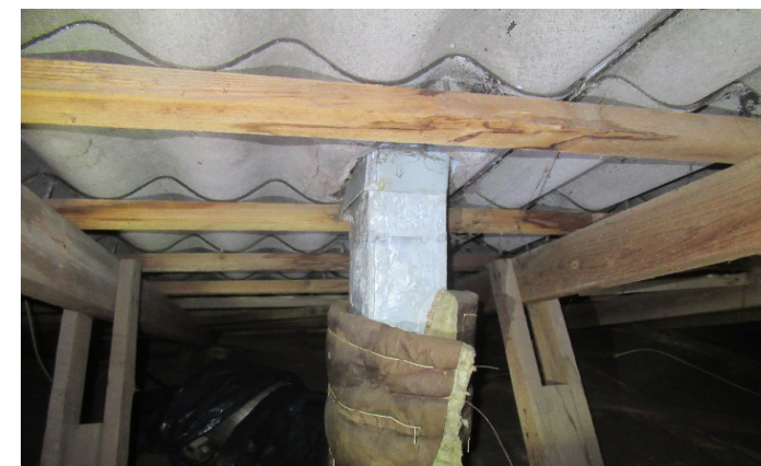
Eksempel på manglende kondensisolering på aftrækskanaler.
