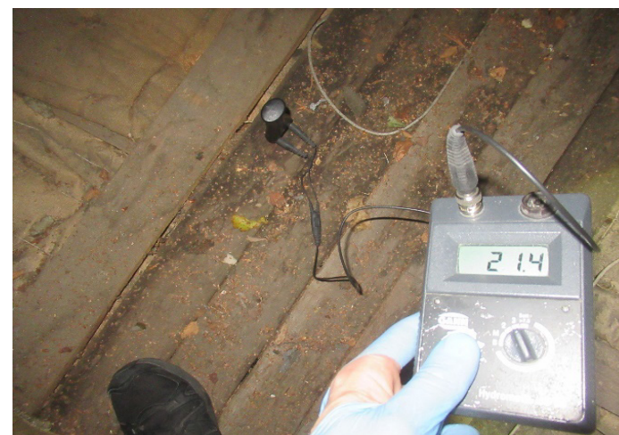
Eksempel på opfugtning af træværk – her gangbro.
