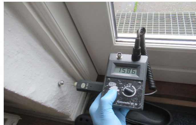
Eksempel på kraftig opfugtning.
