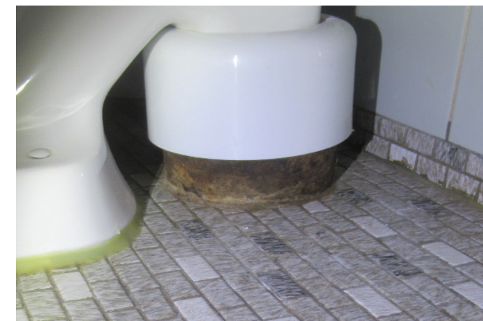
Afløbsinstallationer af støbejern i terrændæk.
