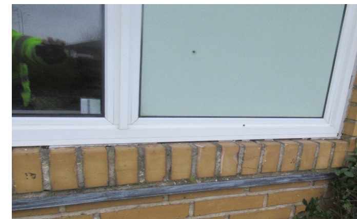
PVC- vinduer årgang 1995, manglende / nedbrudte kalfatringsfuge
