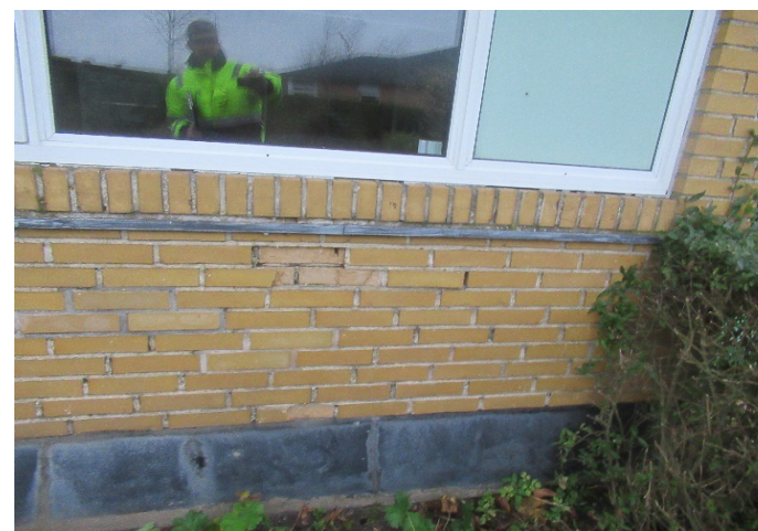
Eksempel på nedbrydning af murværk.
