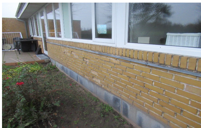
Eksempel på revnedannelser i sokler.
