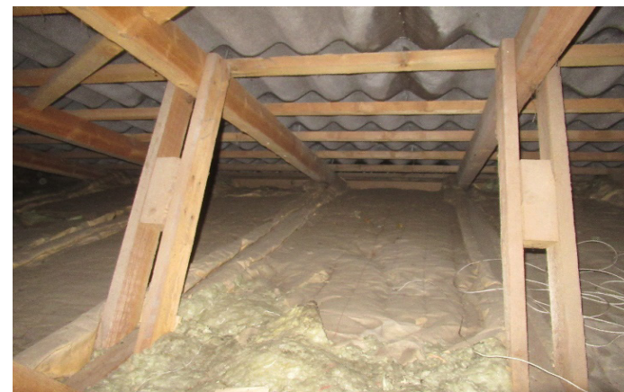
Bølgeplader med asbest – 52 år gl.
