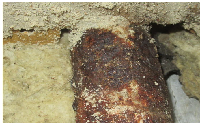
Eksempel på kraftig rusttæring i bærende stålsøjler.
