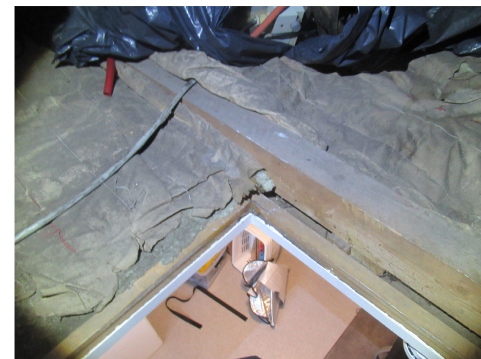
Eksempel på loftslem uden isolering.
