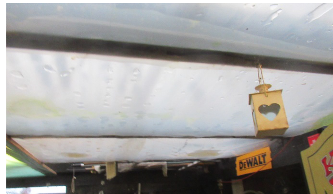
Eksempel carport med utæt tag.
