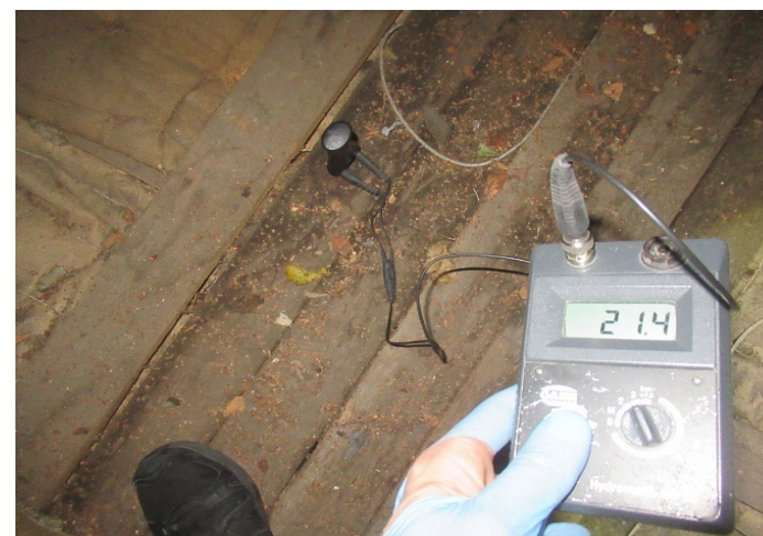
Eksempel på opfugtning af træværk – her gangbro.
