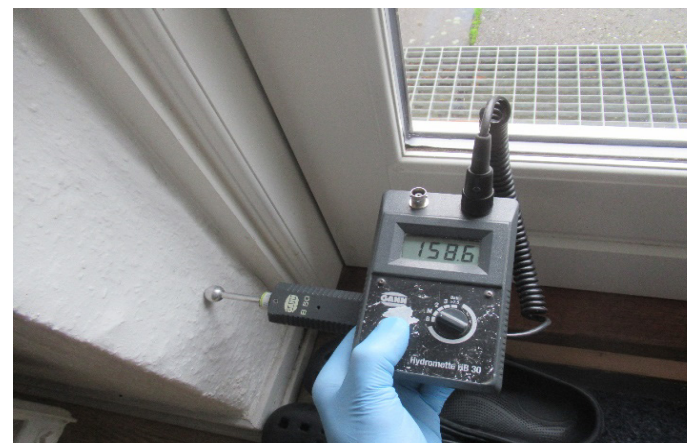
Eksempel på kraftig opfugtning.
