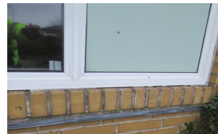
PVC- vinduer årgang 1995, manglende / nedbrudte kalfa-tringsfuge
