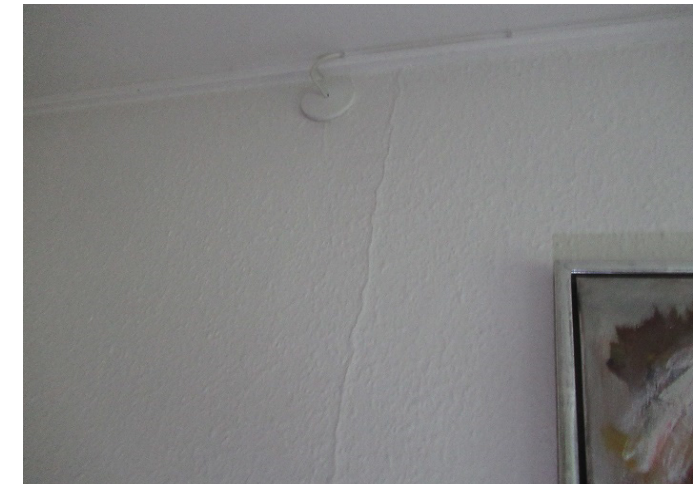
Eksempel på skillevægge med revnedannelse.
