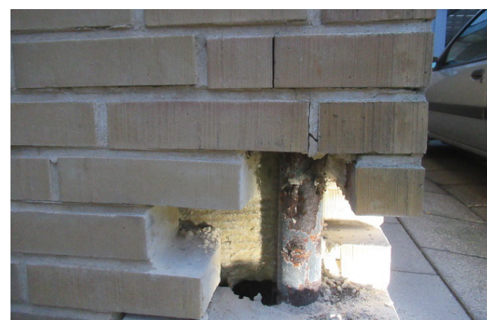
Eksempel på korrosion af bærende stålsøjler.
