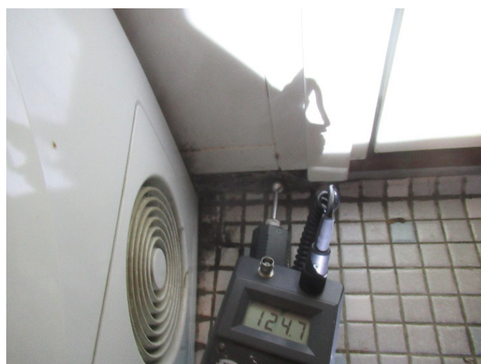
Eksempel på opfugtning grundet kuldebro.
