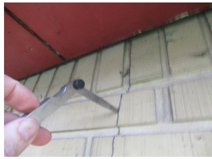
Eksempel på revnedannelse i facade.
