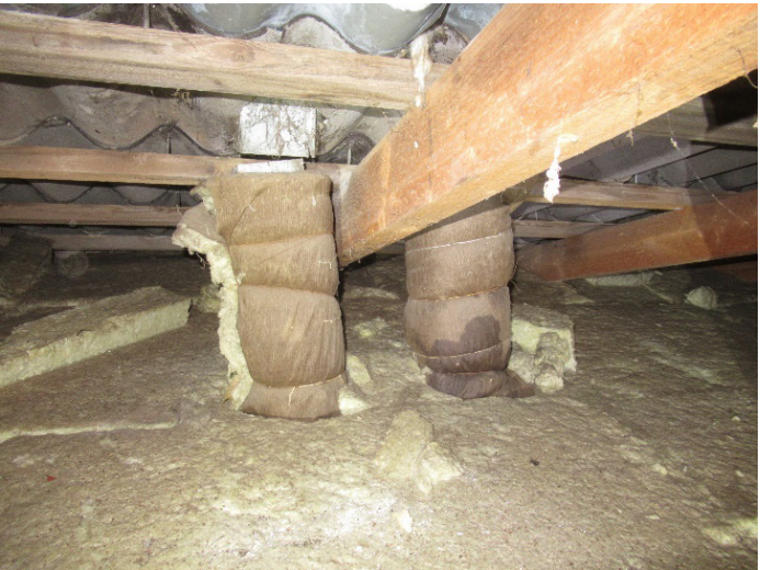
Eksempel på utæt aftrækskanal og manglende kondensisolering.
