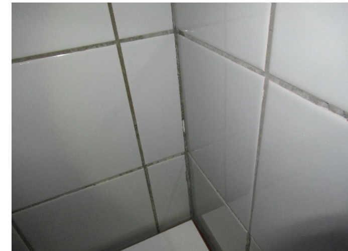
Eksempel på manglende / porøse flisefuger.
