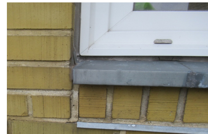
Eksempel på fugeslip i kalfatringsfuge.
