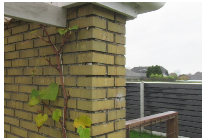
Eksempel på nedbrydning af fuger i murværket.
