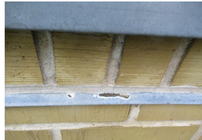
Eksempel på korroderet indskud under sålbænk
