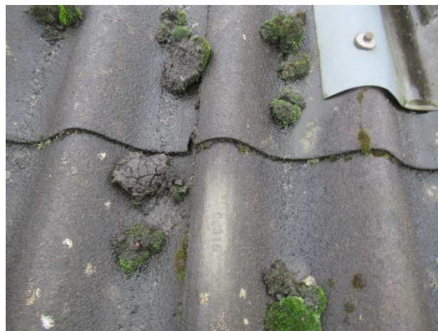
Eksempel på tagplade indeholdende asbest.
