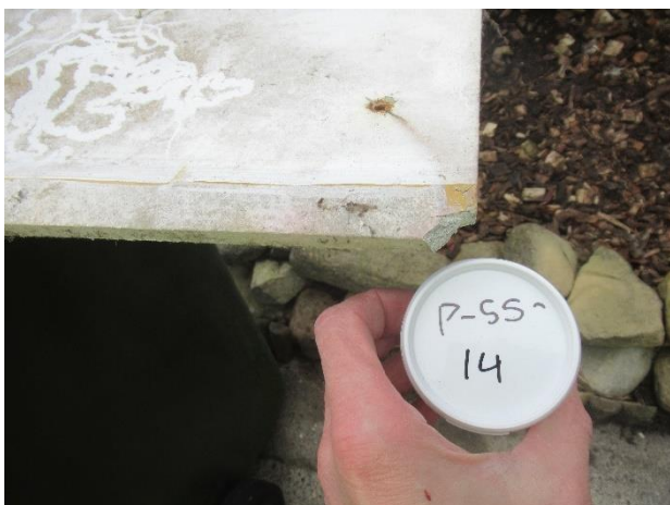
Eksempel på udtagende prøver indeholdende asbest (P-55-14).
