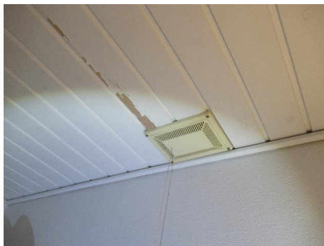
Eksempel på friskluftsventil i badeværelse i nr. 21.
