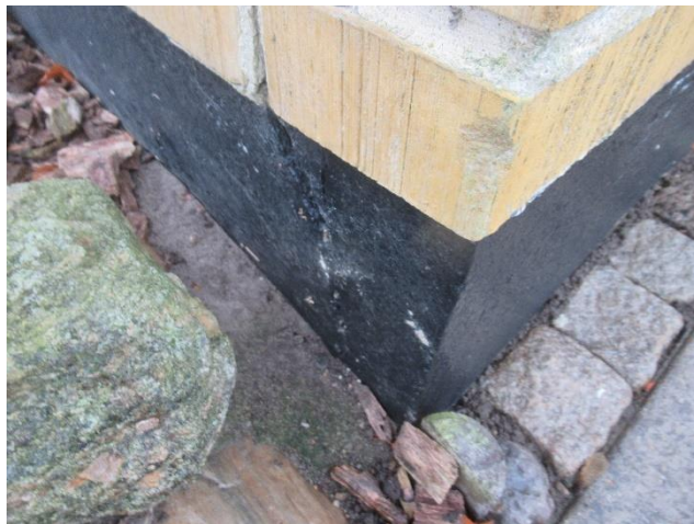
Eksempel revne i sokkel, i forbindelse med bagvedliggende jernsøjle.
