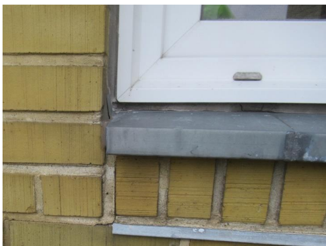
Eksempel på fugeslip i kalfatringsfuge under vindue.
