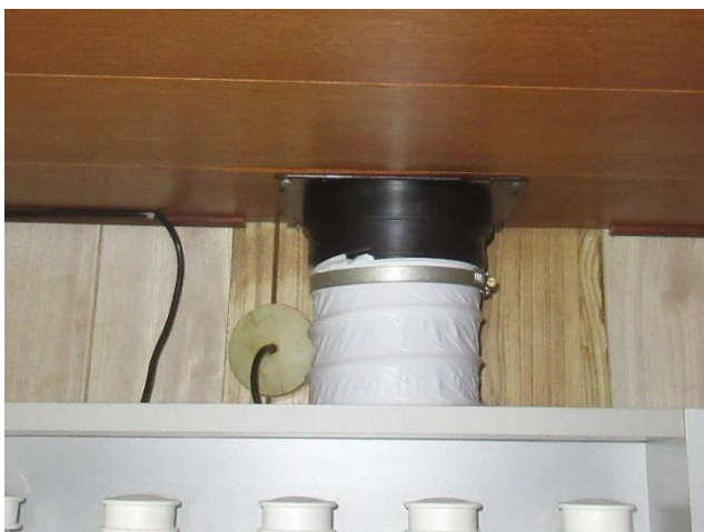
Eksempel på aftræksrør i nr. 16.
