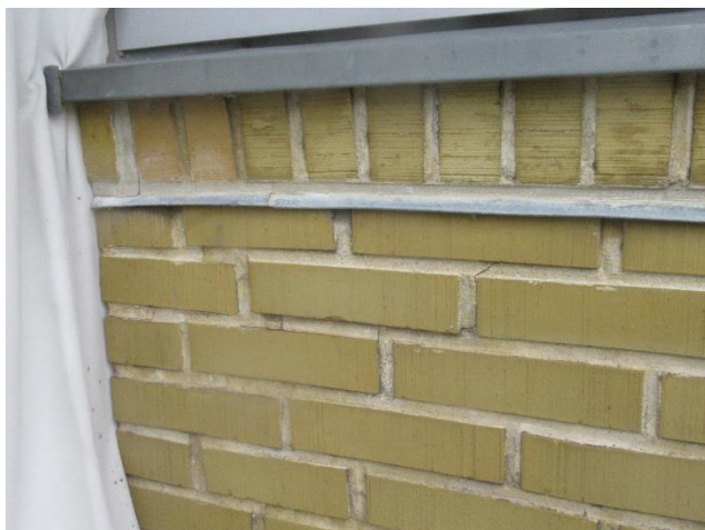
Eksempel på revne i murværk i forbindelse med bagvedliggende stålsøjle i nr. 16.
