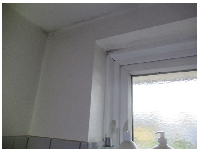
Eksempel på synlig skimmel i overgange mellem vægge og loft/vindue i nr. 25.
