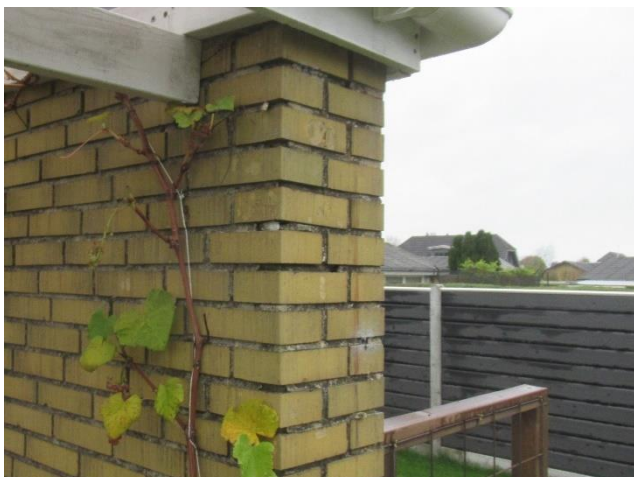
Eksempel manglende/porøse fuger i murværk ved overdækket terrasse i nr. 21.
