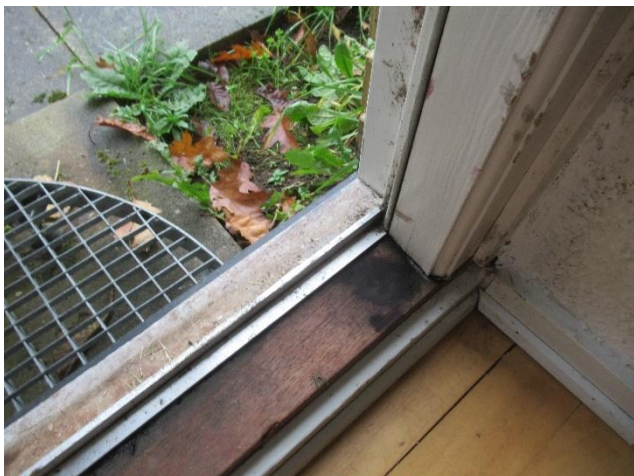
Havedør ved nr. 25. Bemærk mørk plamage på dørtrin som følge af kondensdryp fra dørhåndtag.
