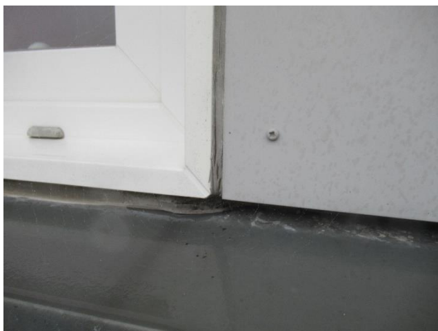
Eksempel på fugeslip ved vindue.
