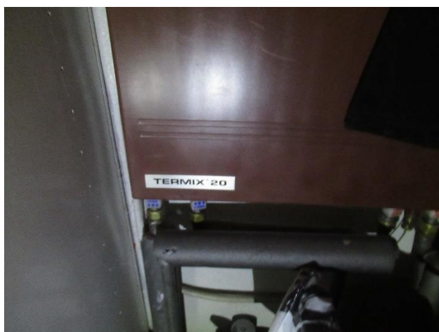
Eksempel på varmeveksler af ældre dato i nr. 16.
