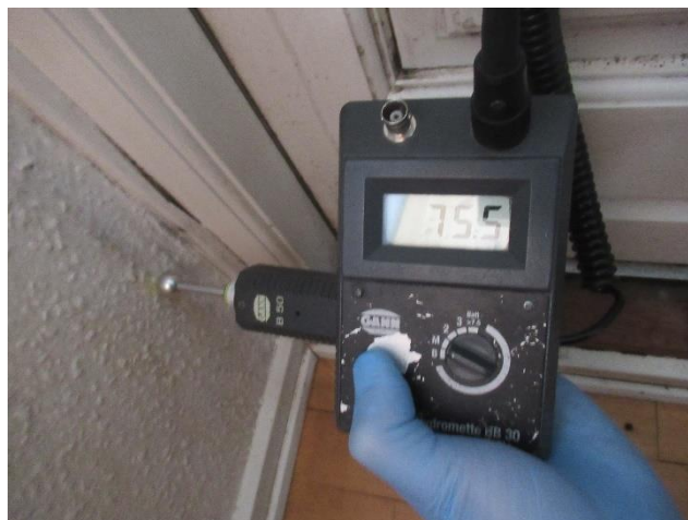
Eksempel på opfugtet skillevæg i forbindelse med havedør i nr. 25. Bemærk at lokationen er umiddelbart bag ovenstående billede
