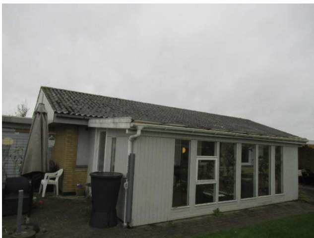
Eksempel på udestue i nr. 21. Bemærk manglende afstand mellem beklædning og belægninger
