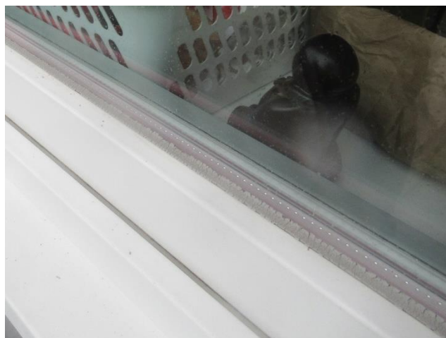
Eksempel på smuldrende tætningslister i PVC-elementer i nr. 14.
