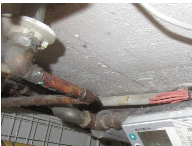
Eksempel på korrosion i vandrør i nr. 25.
