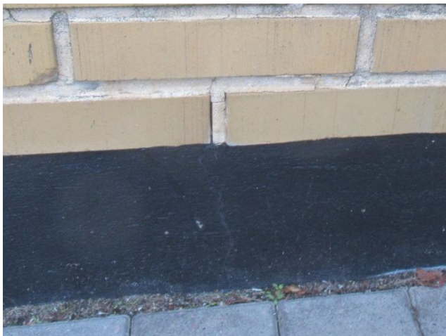
Eksempel på revne i sokkel i nr. 27. Bemærk at revnen er af mindre karakter i soklen, men fortsætter op i facaden.
