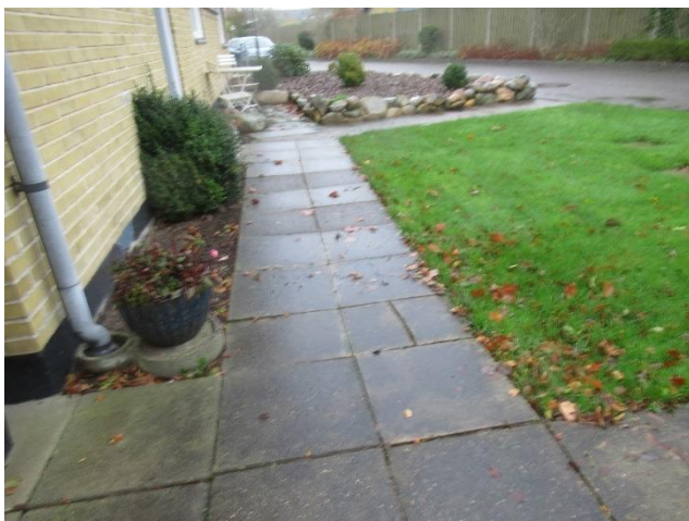
Eksempel på slidt og algebegroet belægning i nr. 27.
