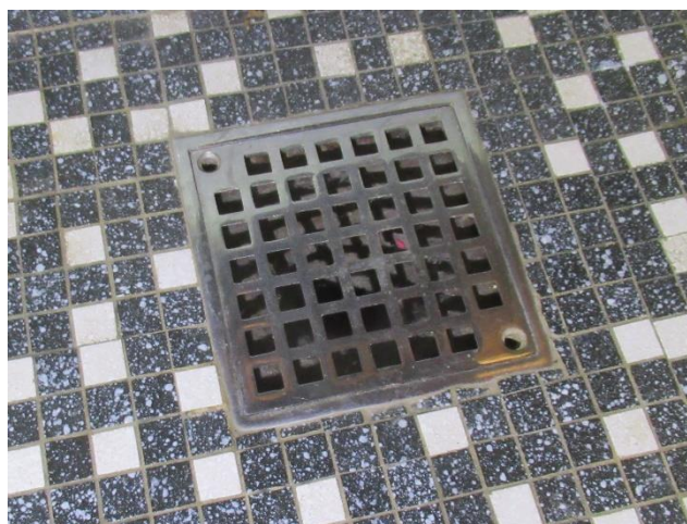
Eksempel på gulvafløb i toilet i nr. 21.
