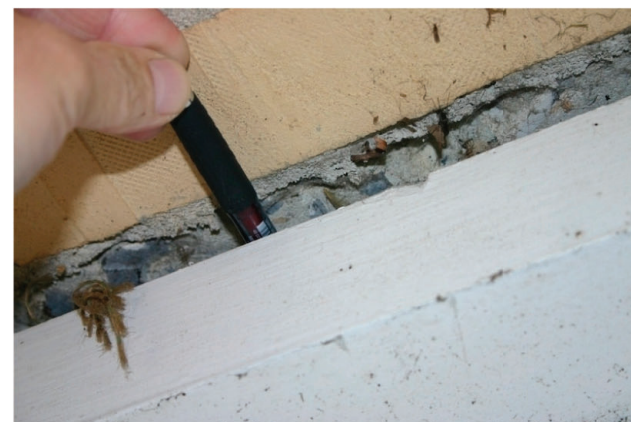
Manglende fuger ved dørkarm
