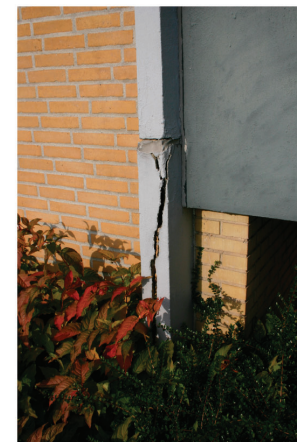
Meget medtaget betonsøjle i facaden
