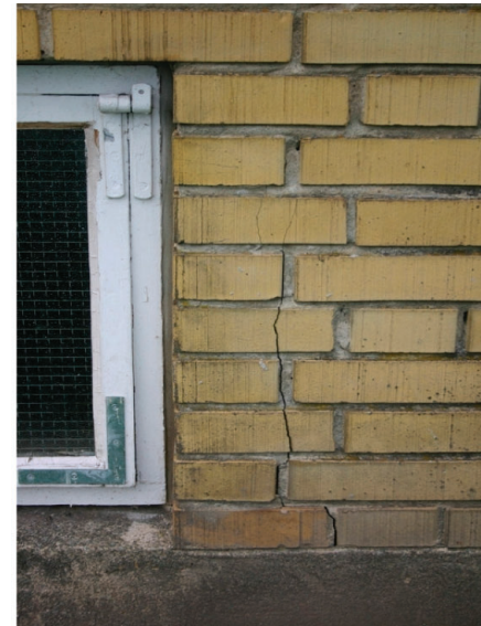
Sætningskade i murværk
