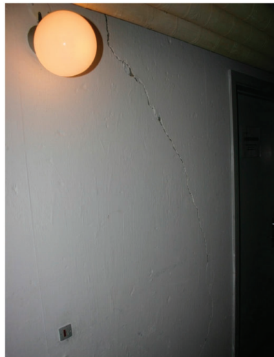
Sætningskade i skillevæg i kælder
