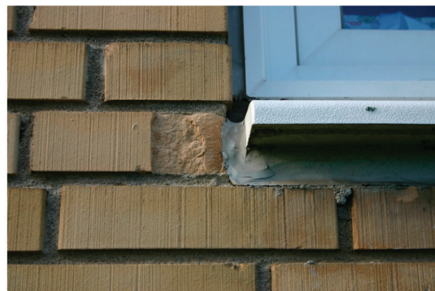
Afskallet teglsten ved ende af sålbænk
